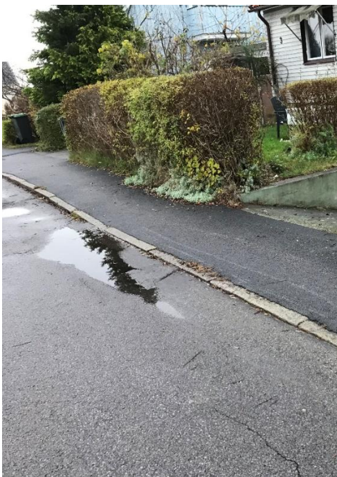
Figur 15. Vy tagen sydöst längs med Svängatan. På bilden syns stående vatten i lågpunkt mittför nedsänkt garagedörr och nedsänkt kantsten vid fastighet som kan riskera att drabbas vid skyfall.
